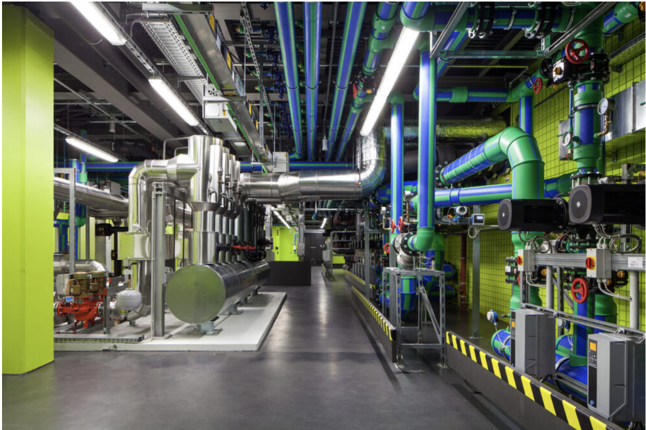
Kühlungsinfrastruktur der Rechenzentren des ZIH, TUD (2022). Foto: Robert Gommlich/©Mit freundlicher Genehmigung des Zentrums für Informationsdienste und Hochleistungsrechnen (ZIH) der TUD.
