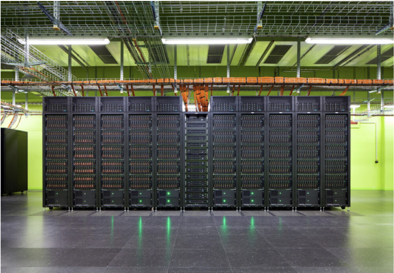
Blick in die Rechenzentren der TUD (2022). Foto: Robert Gommlich/©Mit freundlicher Genehmigung des Zentrums für Informationsdienste und Höchstleistungsrechnen (ZIH) der TUD.
